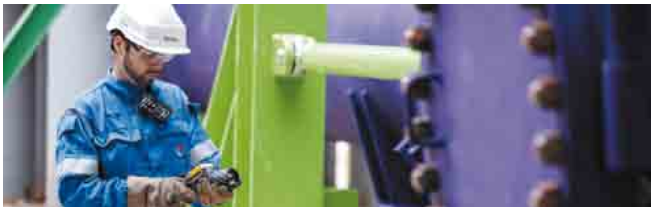
Un technicien recueille des données thermographiques sur un collecteur de l'unité de la raffinerie de Normandie, Harfleur, France.
