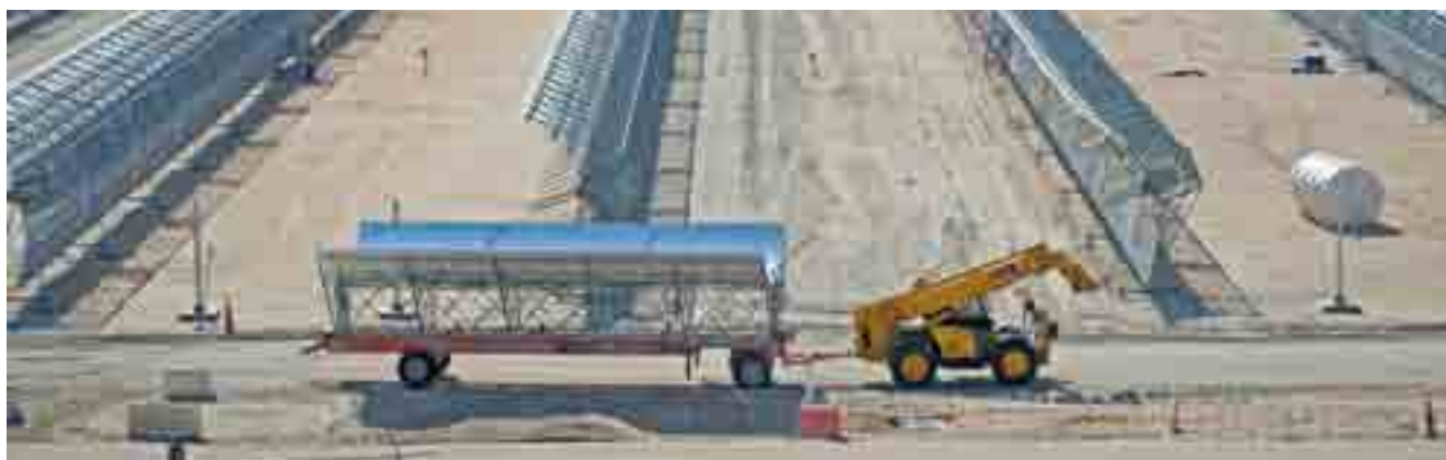
Centrale solaire à Madinat Zayed, Émirats Arabes Unis.
